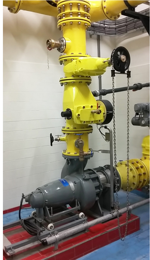
Een close-up van één van de pompen in het rioolgemaal in Rotterdam. De Flygt NZ 3153 in een Z-opstelling.
