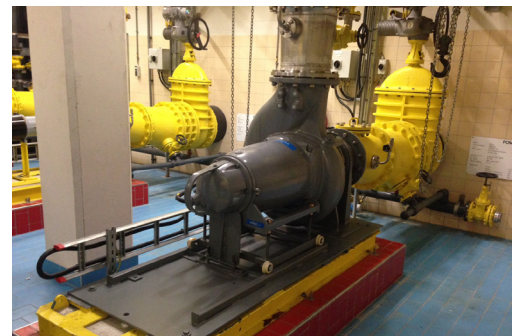
De droog opgestelde Flygt NZ 3202 van Gemaal West-Sidelinge in Rotterdam.
