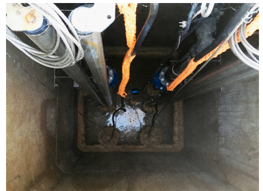
Eén van de probleemgemalen die de gemeente Sluis beheert, waar de Concertor in geplaatst werd om problemen te verhelpen.
